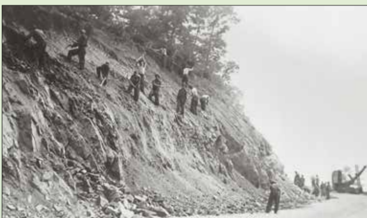
市民部隊によるスカイライン・ドライブの土壌浸食防止工事 NPS (写真下)-NPS / ED KNEPLEY
